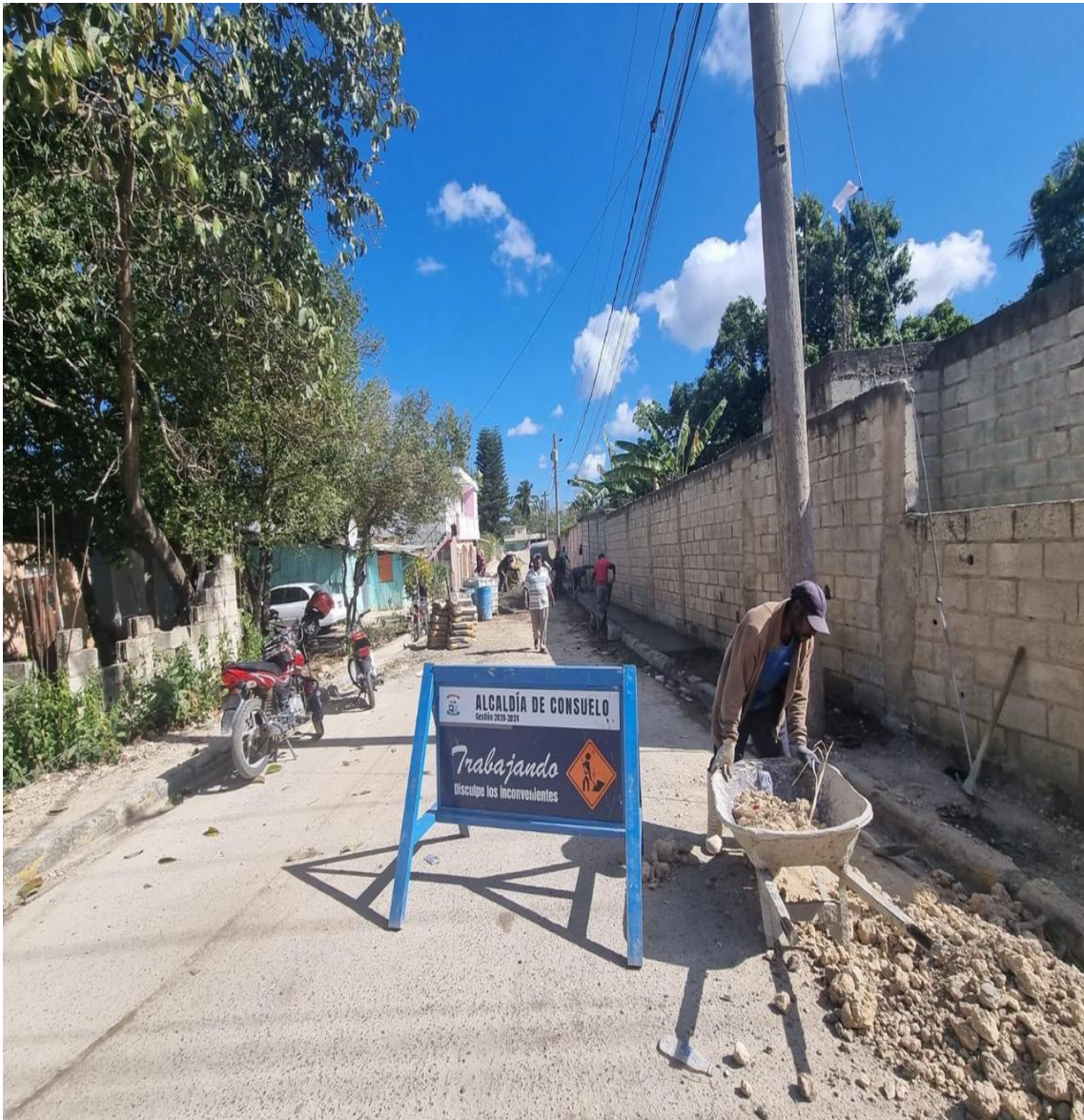
Alcaldía de Consuelo, construcción de Aceras y Contenes, en esta ocasión en Barrio Libertad en Pueblo nuevo la calle antes del Asilo, también en el Barrio Puerto Rico y Pueblo Nuevo.
